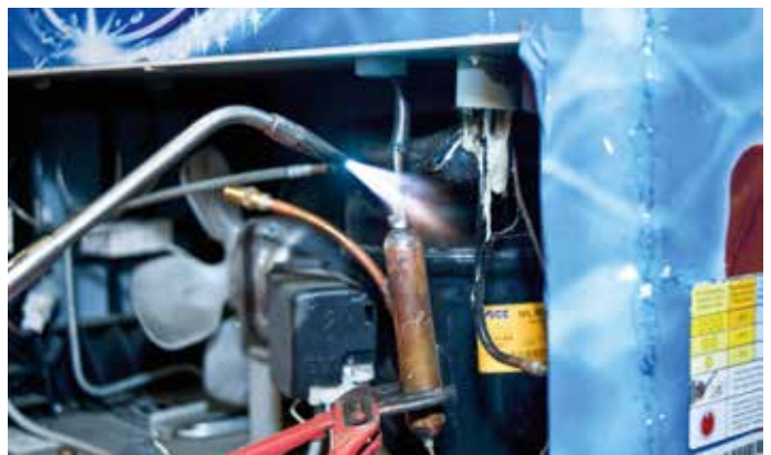
Grundsätzlich hat es oberste Priorität für die HAVO Group, ein defektes Kühlmöbel bei ihren Kunden vor Ort instandzustellen.
